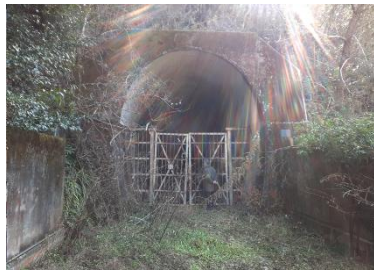
トンネルも完成していましたが、残念ながら、柵で封鎖されています。
